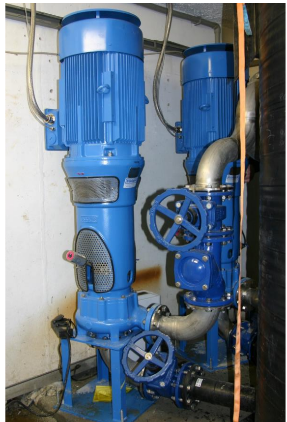
Turo®-Pumpen zur Förderung von Rohabwasser Fabriknummer T251369-70
