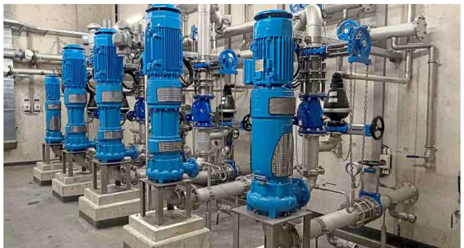
Pumpwerk Terminal 3 – WEST – Neubau mit klassischem Pumpensumpf und zwei Förderwegen Emile Egger
