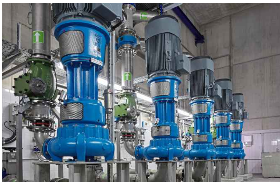
Hauptpumpwerk Fraport AG: 5 Pumpen Typ TA 91-150 V6 LB5B (Inbetriebnahme 2015) Emile Egger
