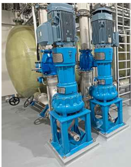
Pumpwerk Terminal 1 nach Sanierung 2023 mit GFK-Tanks als Pumpenvorlage – 5 Pumpen TA 81-150 V6 LB4Bex Emile Egger
